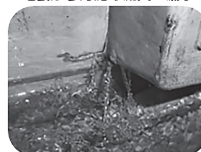
亀裂から汚泥の流出・漏水
