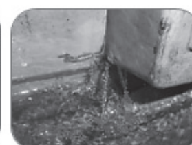
亀裂から汚泥の 流失・漏水
