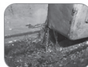
亀裂から汚泥の 流出・漏水
